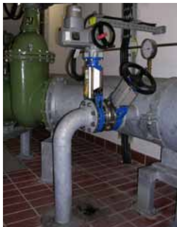
Насосная станция Колленхоф, Германия 2 VAG ZETA® Ножевые задвижки
